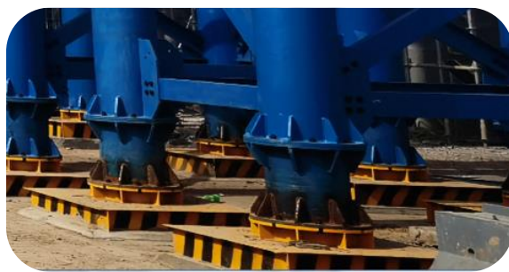
钢制路基箱基础
